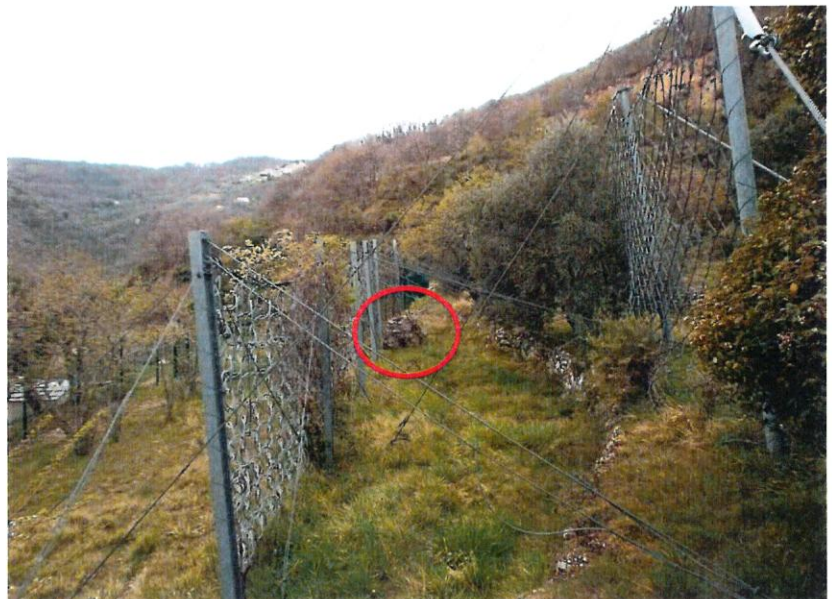
Ecrans pare blocs en amont de l'usine des Eaux Bloc arrêté contre le grillage
