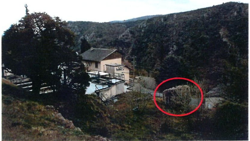
Bloc arrêté dans le périmètre de l'usine des Eaux Photo du 12 avril 2019
